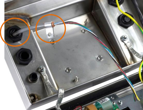
Figura 2-31: Cabo da Célula de Carga do Gabinete do IND236, com Clipe de Aterramento do Chassi
